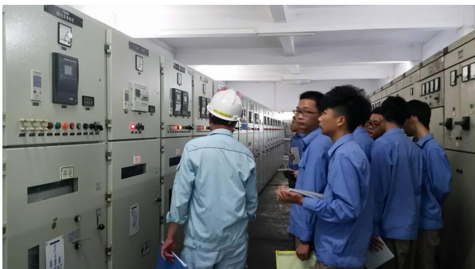
茂化建总部配电所现场教学
