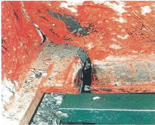
图 1-1 梁焊接脆性断裂
