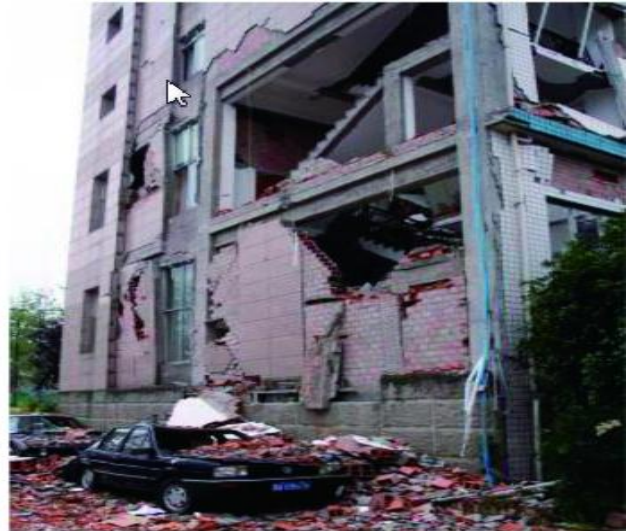
图 1-2 维护墙体掉落
